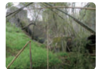
水を発電機に落とす導水管
