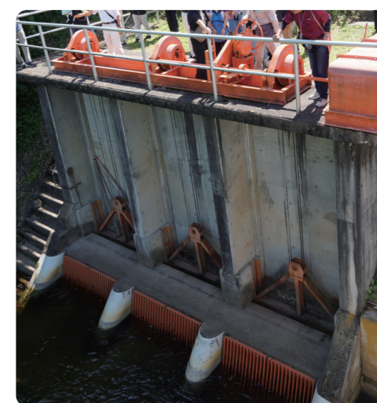
じょうぶ まわ これが取水口です。上部のハンドルを回して、ゲートを開けて川の水を取り入れます。
