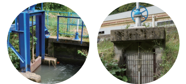
取水口(水を取り入れる)
