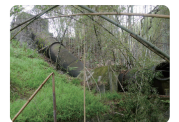
水を発電機に落とす導水管
