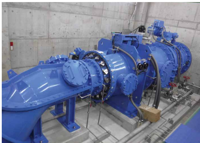
写真③: 水車発電機
