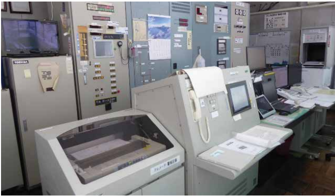
①:ダム水管理設備等の更新(R5完了予定) 耐用年数を超過した機器類を新しくします。
