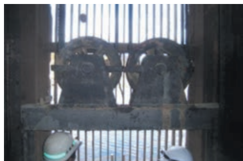
錆による腐食が著しい取水ゲート開閉装置
