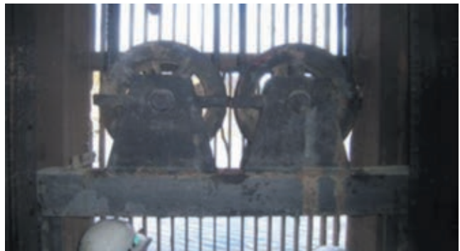
錆による腐食が著しい取水ゲート開閉装置
